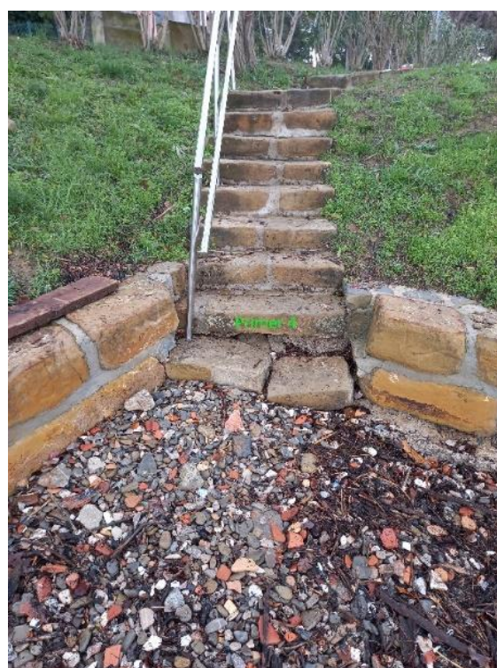
Slika 2.4: Poškodba na kamnitih stopnicah na plaži Valdoltra
