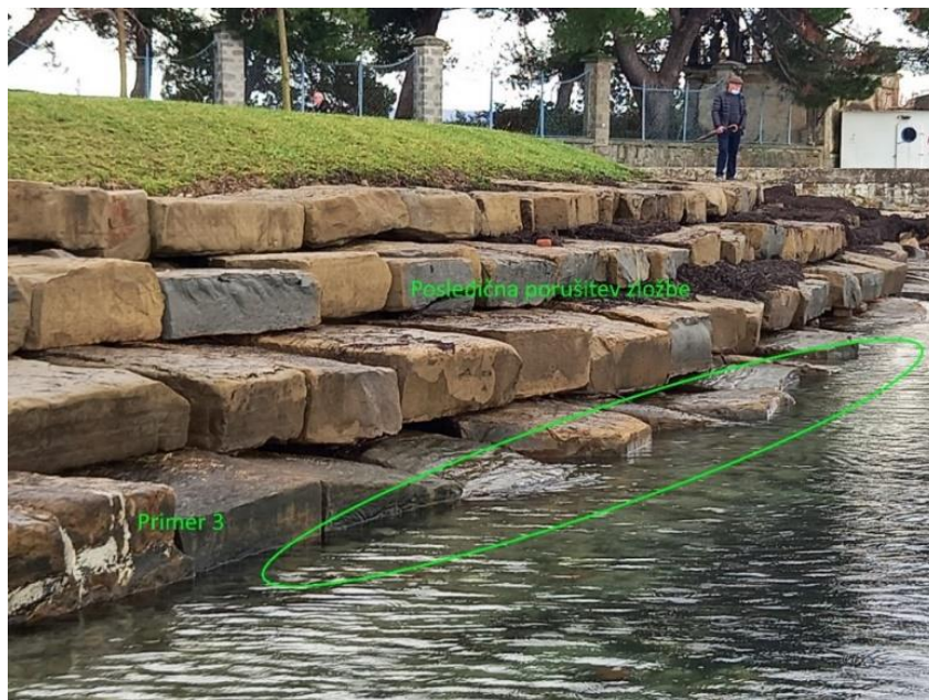
Slika 2.5: Poškodba na skalometu pri plaži Valdoltra
