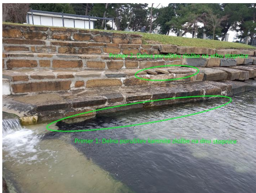
Slika 2.3: Poškodbe na kamniti tribuni na plaži Valdoltra
