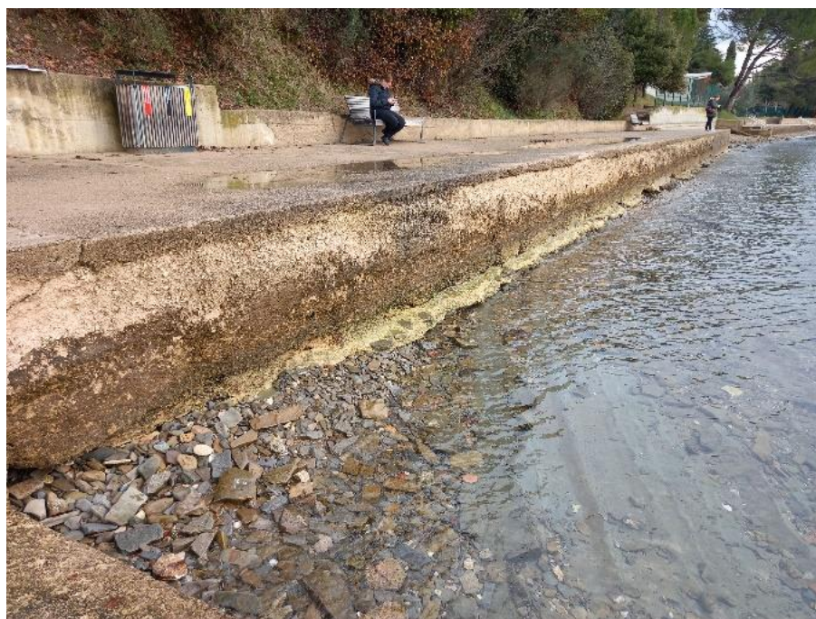
Slika 2.6: Poškodbe na obalnem zidu na plaži Ankarančani
