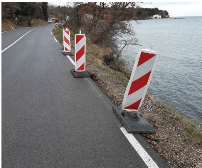
Prikaz trenutnega stanja udrtih bankin ob vozišču, kjer sta predvideni izvedba novega podpornega zidu in namestitve varovalnih ograj. / Lo stato attuale delle banchine stradali infossate lungo la carreggiata, dove è prevista la realizzazione di un nuovo muro di sostegno e l'installazione di recinzioni di protezione. (Foto: Občina Ankaran / Comune di Ancarano)
